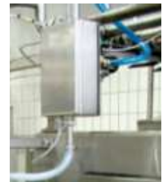
Abb. 5: Separator montiert an dem Abfluss der Resteentleerung
